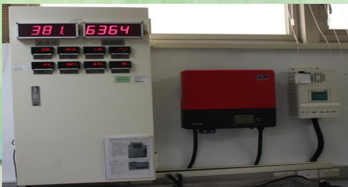
3.2 kW 太陽能發電系統
