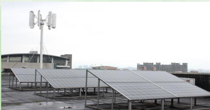
3.2 kW 太陽能發電系統
